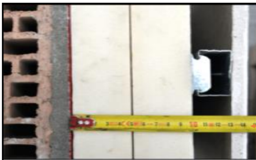
Parete isolata con pannelli di isolante rigido spessore 10 cm. Spessore tot. controparete circa 14,5 cm
